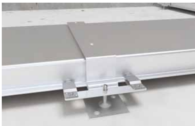
Использование элементов заземления кабельных каналов
