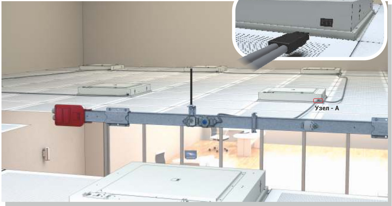
Фальшпотолок (Контур системы освещения)
